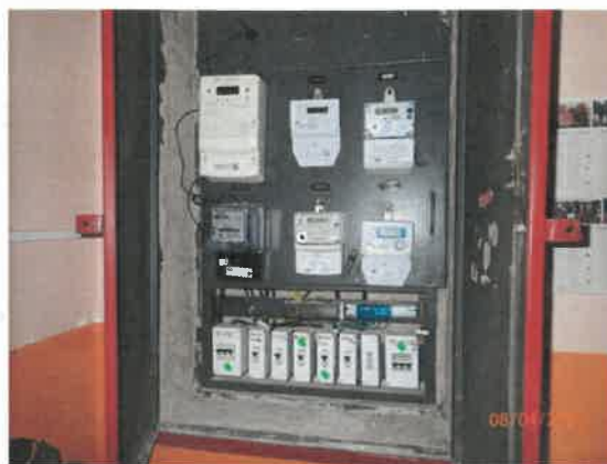
Elektrometry pre byty na spoločnej chodbe
