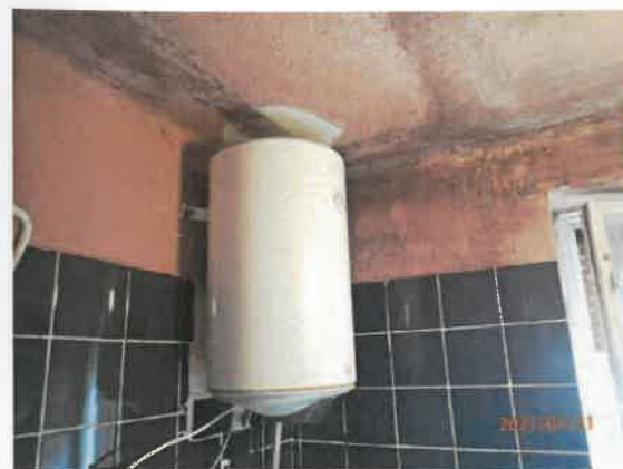
Elektrický bojler v kúpeľni
