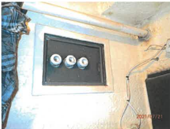
Pôvodný rozvádzač v byte
