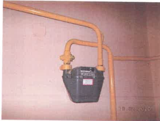
Plynomer pre byt pred vchodom do bytu
