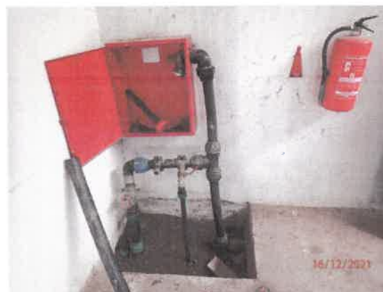
Požiarňý vodovod v sklade
