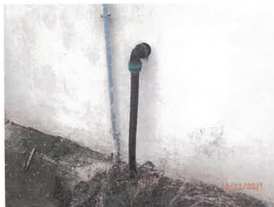
Vstup požiarneho vodovodu do skladu
