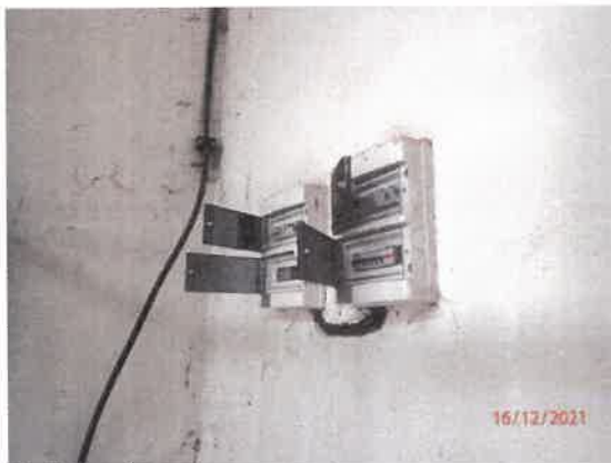
Rozvádzač ELI v sklade
