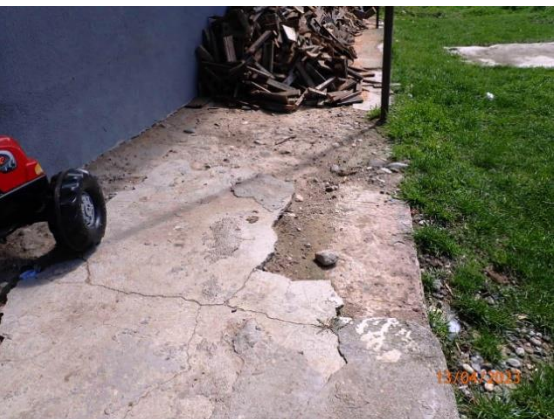
Poškodenie chodníka okolo domu
