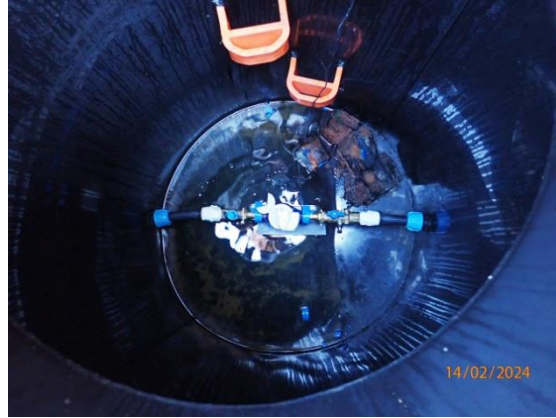
Pohľad do vodomernej šachty
