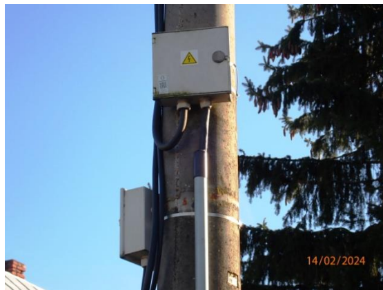
Bod napojenia na elektro na stĺpe pred domom
