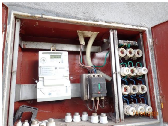
Elektromerná skrinka na fasáde domu
