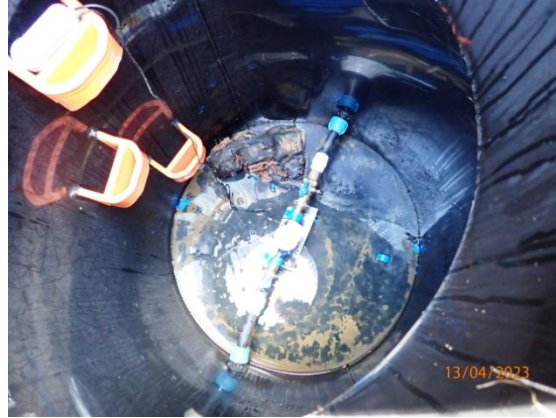
Pohľad do vodomernej šachty
