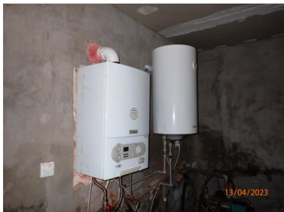
Kotol ÚK na plyn a elektrický bojler
