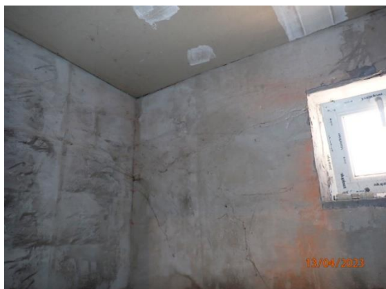
Nedokončený povrch stien v kotolni
