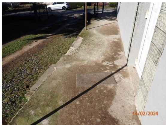
Poškodenie chodníka okolo domu
