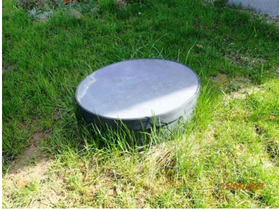
Vodomernej šachty pred domom
