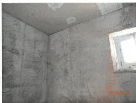
Nedokončený povrch stien v kotolni
