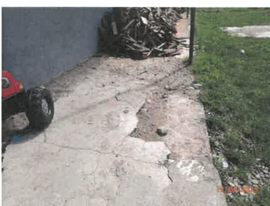
Poškodenie chodníka okolo domu
