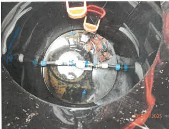
Pohľad do vodomernej šachty
