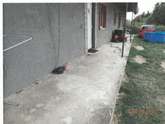
Poškodenie chodníka okolo domu
