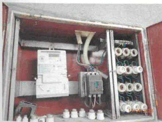
Elektromerná skrinka na fasáde domu
