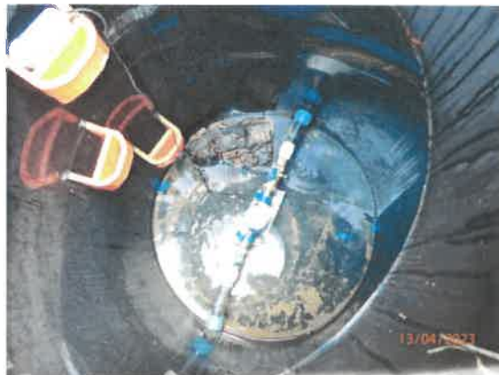
Pohľad do vodomernej šachty
