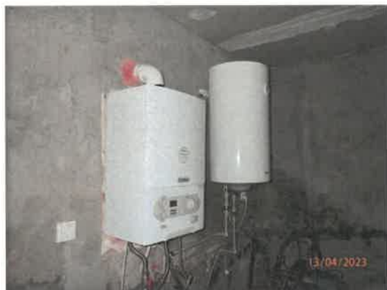
Kotol ÚK na plyn a elektrický bojler
