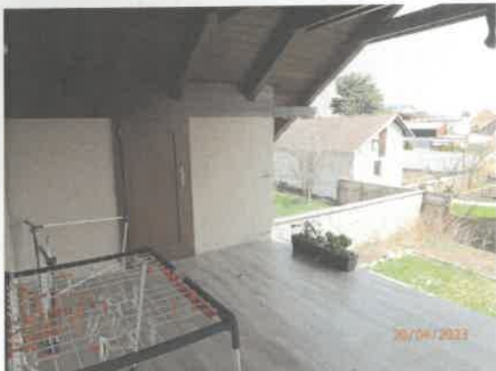
Terasa nad prístavbou bez zábradlia
