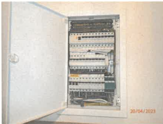
Rozvádzač ELI v dome
