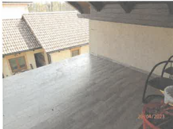
Terasa nad prístavbou bez zábradlia
