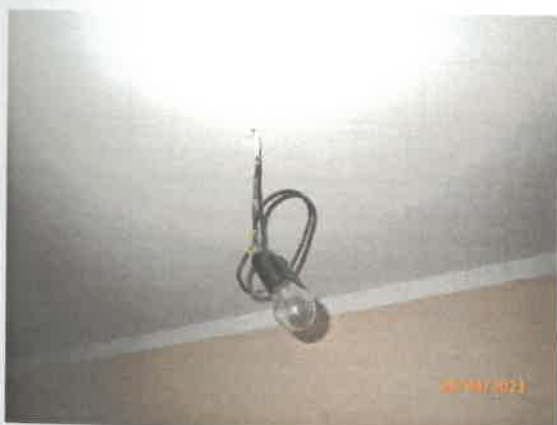
Chýbajúce svietidla v dome
