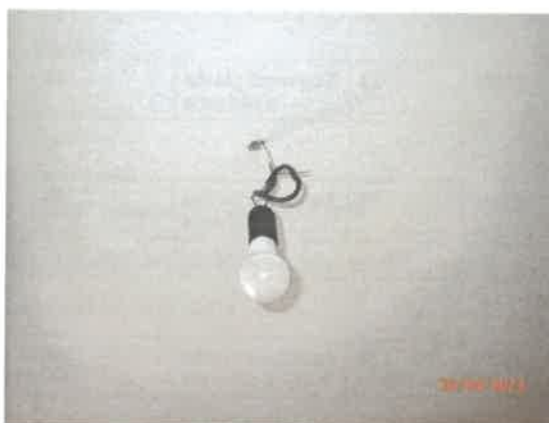
Chýbajúce svietidla v dome
