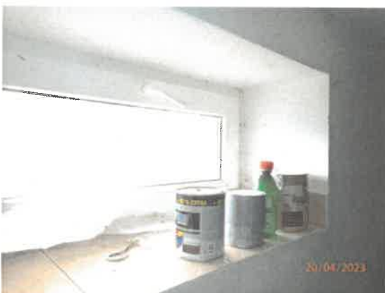
Detail okna skladu v prístavbe suterénu
