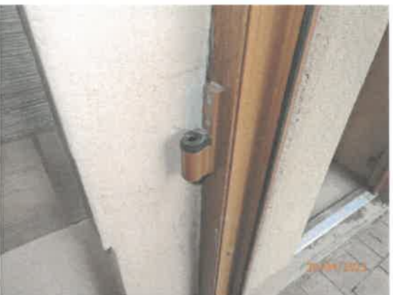
Chýbajúce dvere do skladu garáže
