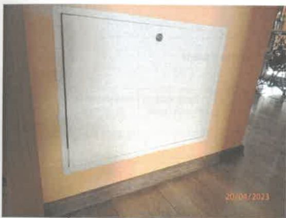
Rozvádzač UK v podkroví
