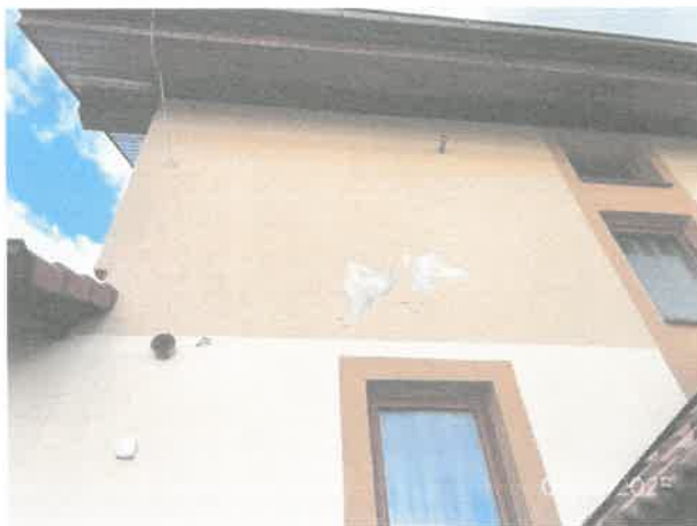
opadaná omietka na severnej fasáde
