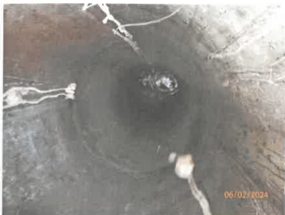
Pohľad do studne – zasypaná odpadom
