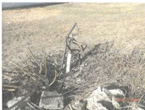
Poškodená prípojka plynu na pozemku
