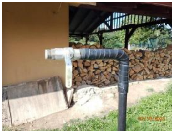
Prípojka plynu z nádrže do domu
