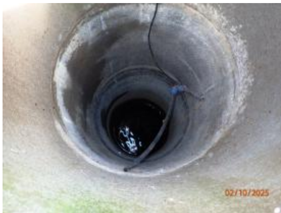
Pohľad do nefunkčnej studne na parc. 216/1
