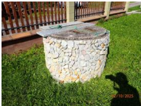
Nefunkčná studňa pri dome na parc. 216/1
