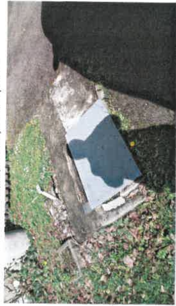
Pohľad na chýbajúce umývadlo v práčovni
