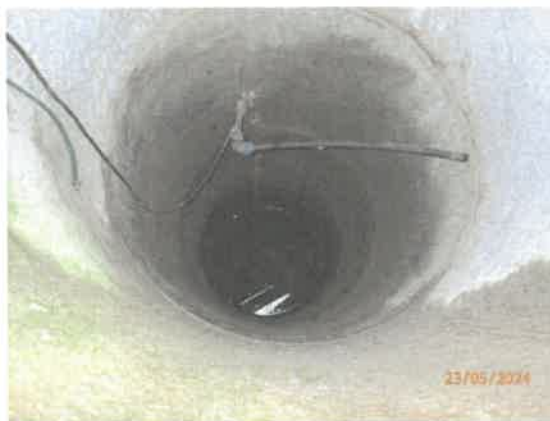
Pohľad do nefunkčnej studne na parc. 216/1
