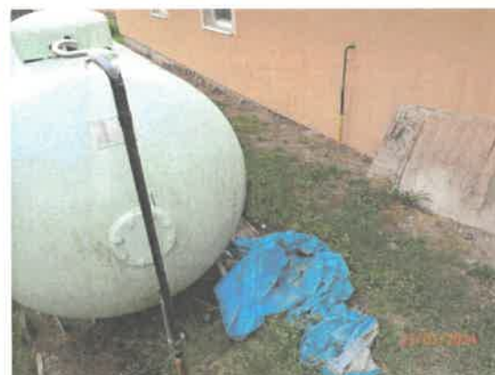
Prípojka plynu z nádrže do domu
