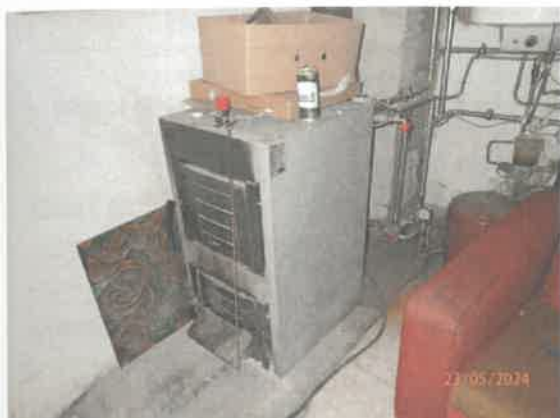
Kotel ÚK na tuhé palivá
