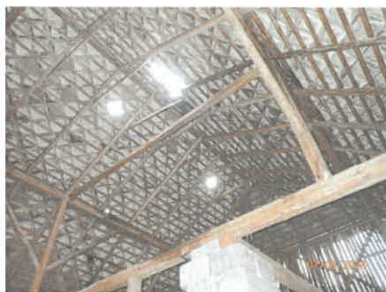
Poškodená strecha stodoly
