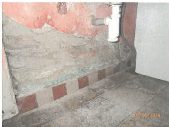
Poškodené steny chodby na I.NP
