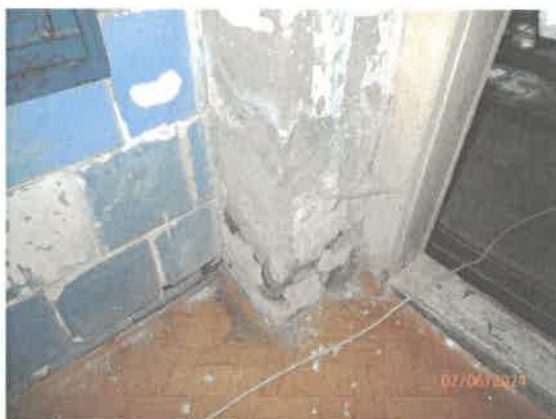
Poškodené steny skladu na I.NP
