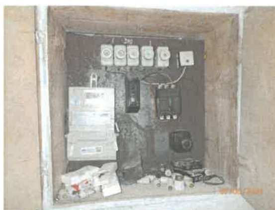
Rozvádzač ELI s elektromerom na fasáde domu
