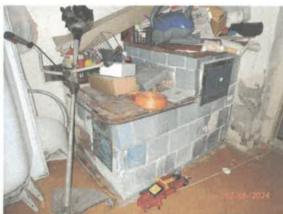
Nefunkčná poškodená pec v sklade na I.NP
