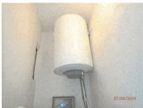
Elektrický bojler vo WC na II.NP
