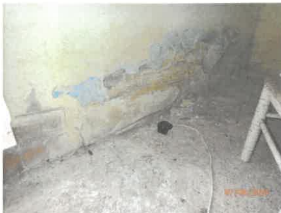
Poškodené steny skladu na I.NP
