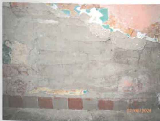
Poškodené steny chodby na I.NP
