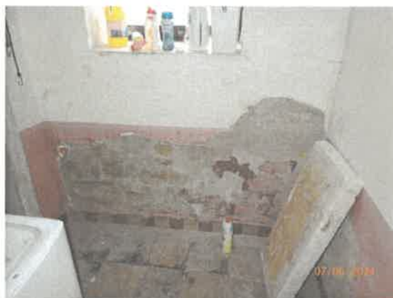
Poškodené steny chodby na I.NP
