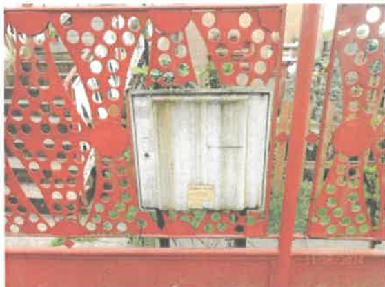
Plynomer v plote od ulice pred domom
