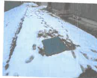
armatúrna šachta so studňou
