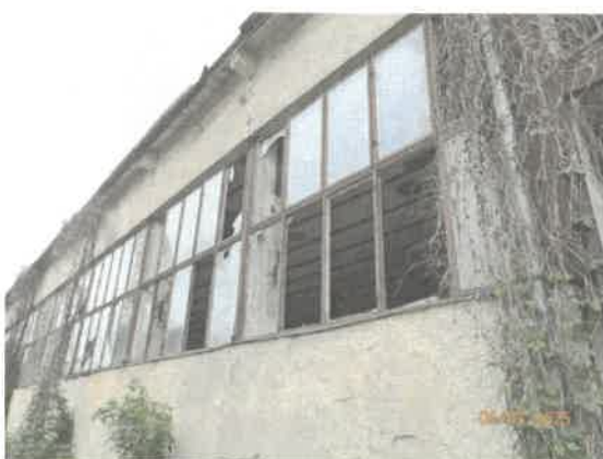
Poškodené okná na južnej strane haly
