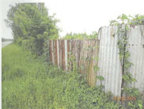
Poškodený plot na severnej strane
