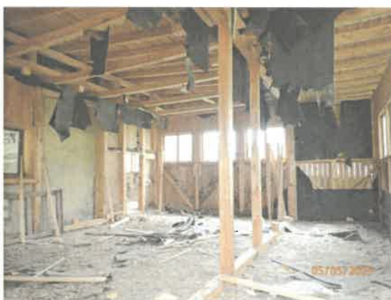
Pohľad do poškodenej prístavby stavby
