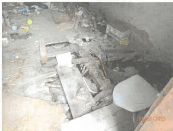
Poškodená drevená podlaha kotolne
