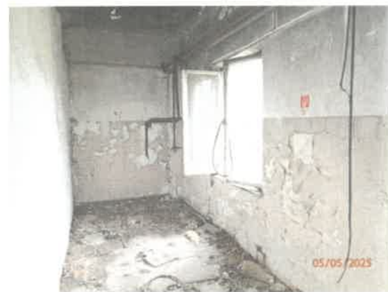
Kotolňa v budove
