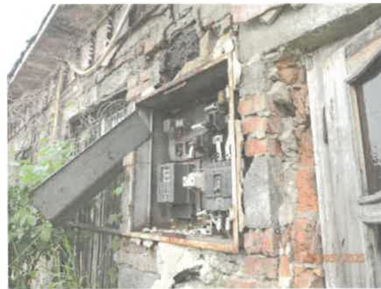
Rozvádzač ELI s elektromerom na fasáde
