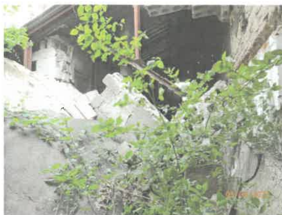
Prepadnutý strop časti kotolne
