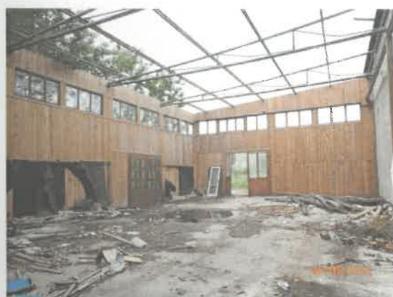
Poškodená prístavba kotolne na južnej strane
