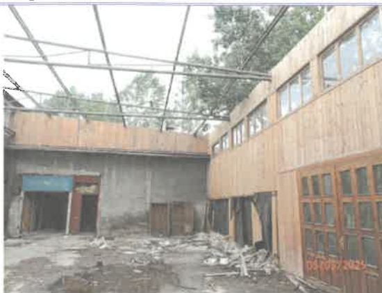
Poškodená prístavba kotolne na južnej strane
