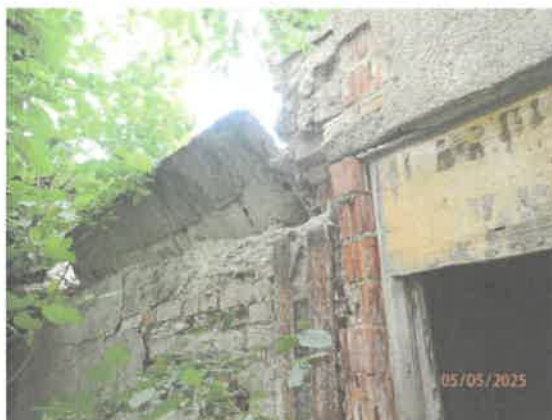
Prepadnutý strop časti kotolne
