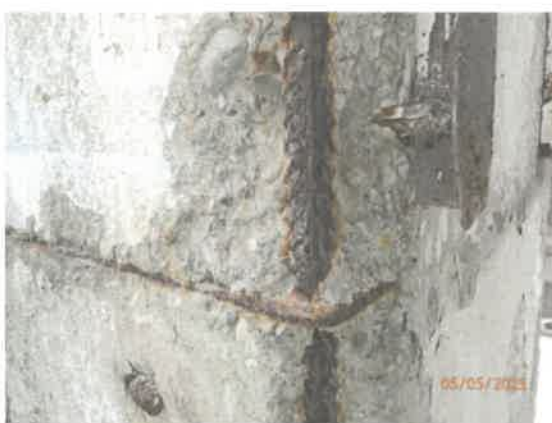
Poškodená výstuž časti nosného systému
