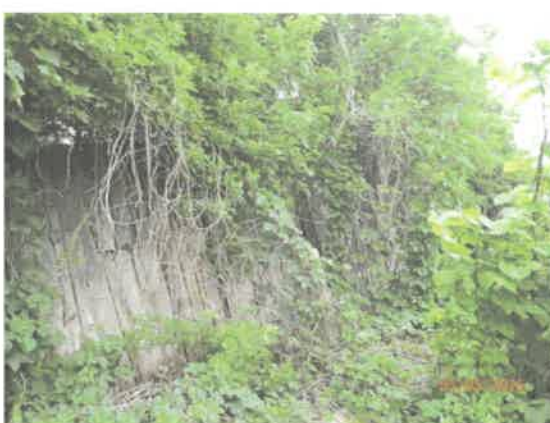
Poškodený plot na južnej strane areálu
