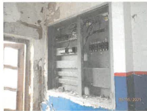
Rozvádzač stavby v predsieni
