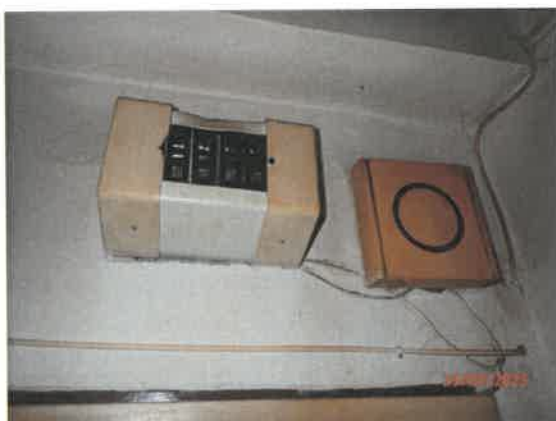
Pôvodný rozvádzač ELI
