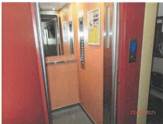
Nový výťah v dome
