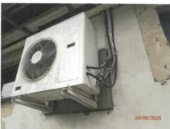
Vonkajšie jednotky klimatizácie na sev. strane
