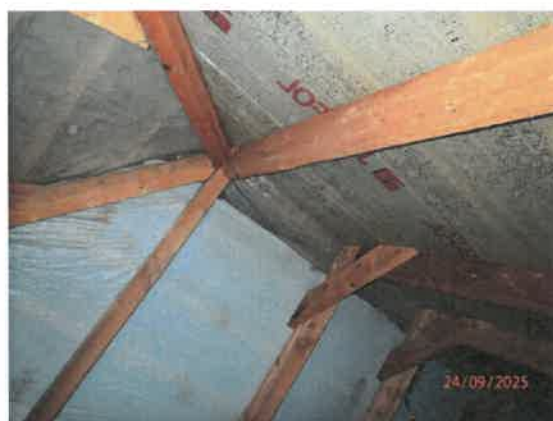
Detail strechy – degradovaná poistná fólia
