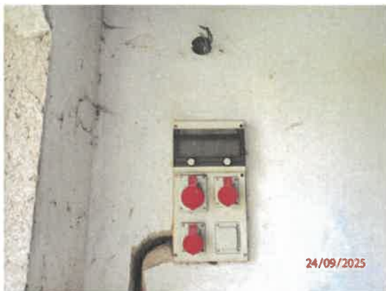
Rozvádzač ELI v dvojgaráži
