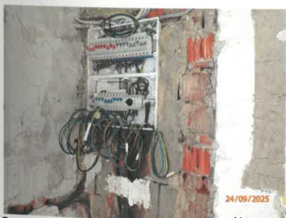
Rozvádzač ELI na I.NP
