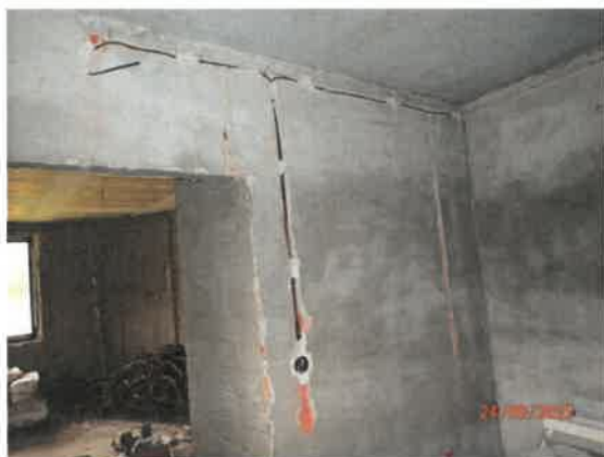
Rozvody ELI na I.NP
