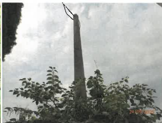
Vzdušná príp. elektro do elektromernej skrinky
