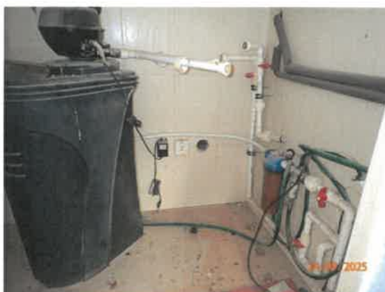
Úpravňa vody na I.NP
