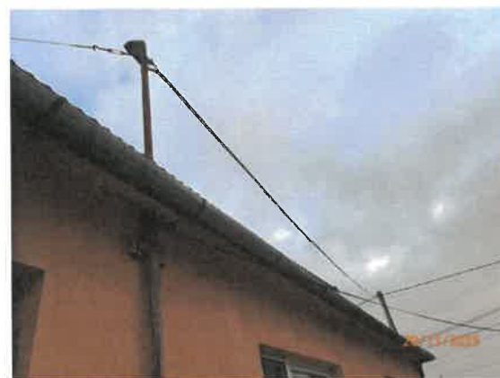
Vzdušná prípojka elektro do domu
