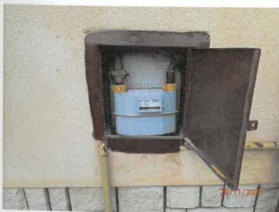
Plynomerná skrinka na fasáde domu
