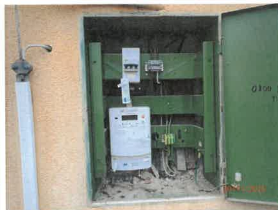
Elektromer a hlavný istič na fasáde domu
