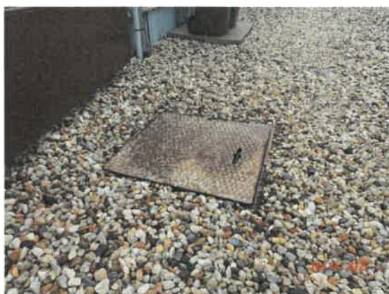
Vodomerňá šachta vo dvore
