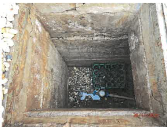
Pohľad do vodomernej šachty
