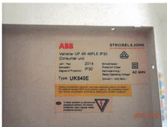
Štítok rozvádzača – r.v. 2014
