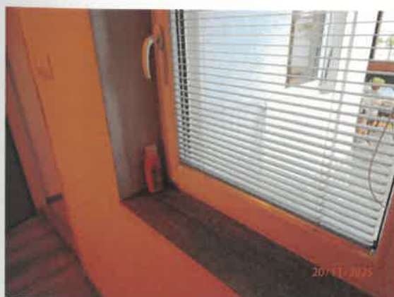
Detail okna zadnej izby
