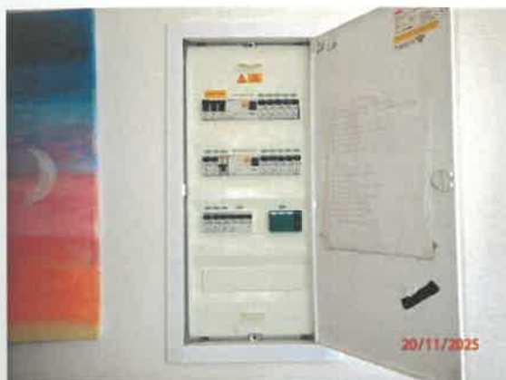
Rozvádzač ELI v dome
